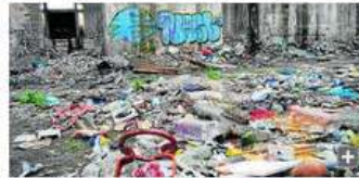
La entrada a las naves de Renfe en San Jerónimo, convertida en un vertedero.
